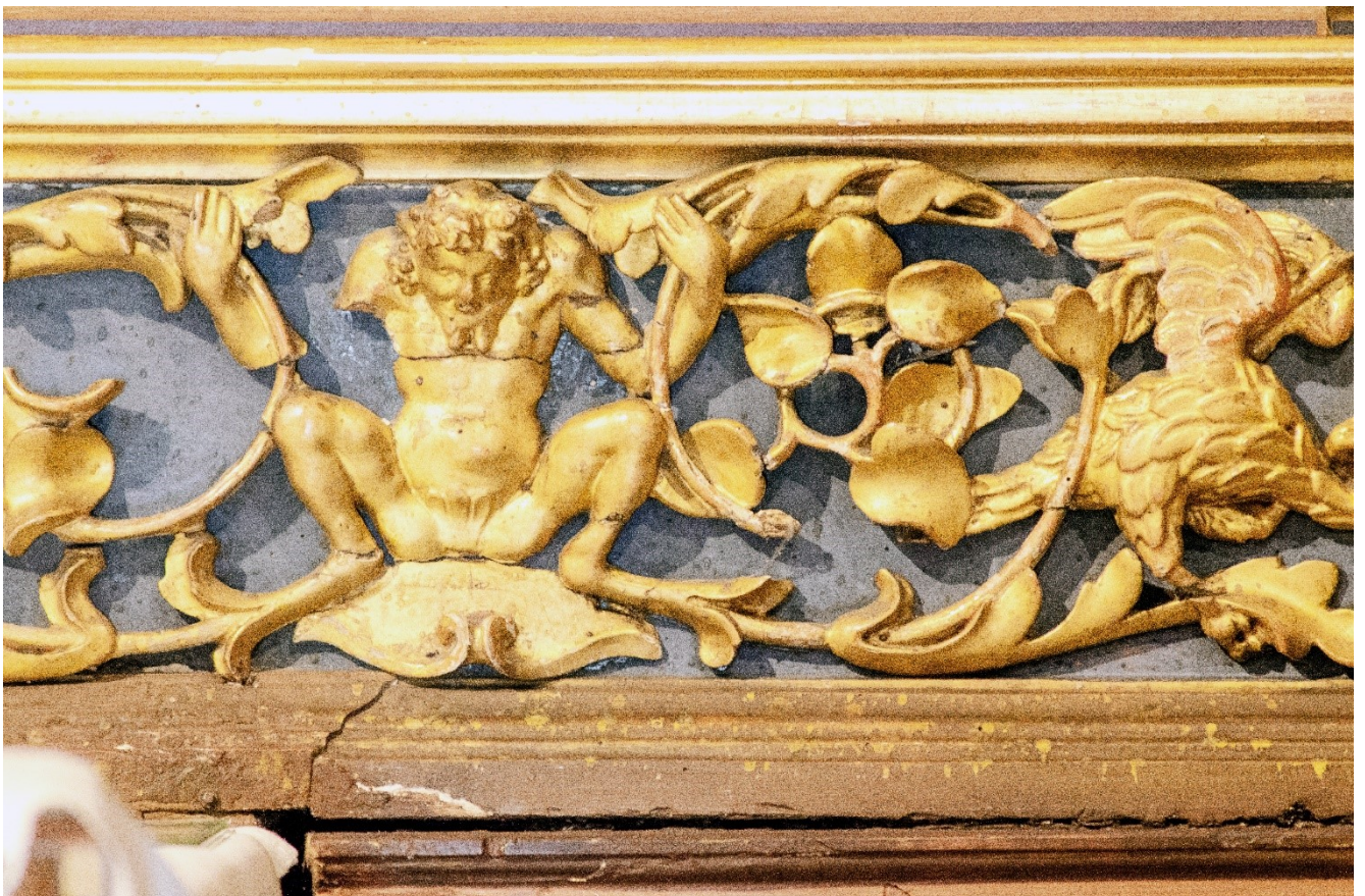
Dettaglio grottesche con evidenza di deterioramenti
